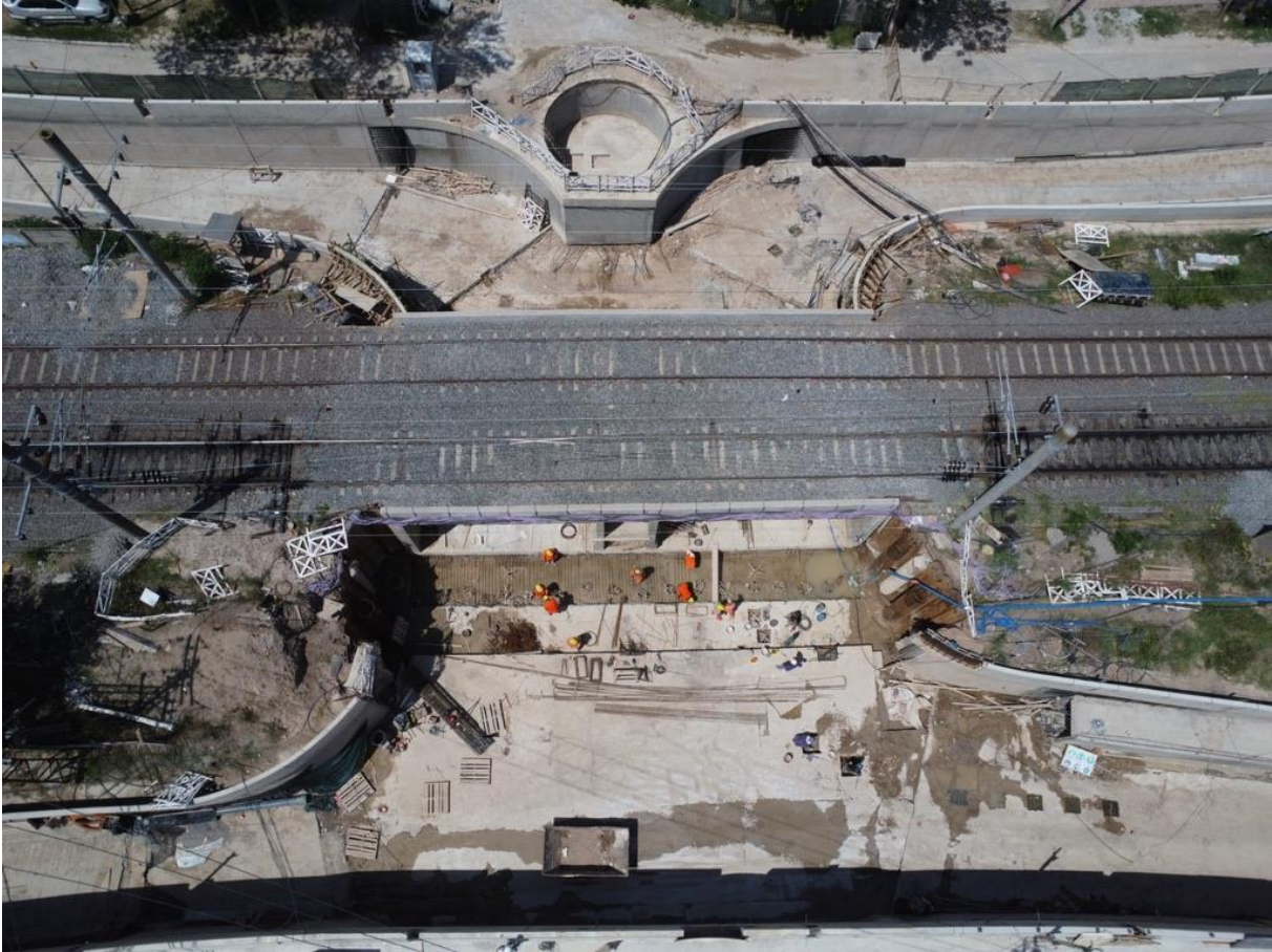
Figura 14 - Vista aérea en febrero de 2023, en la parte superior la estación de bombeo
